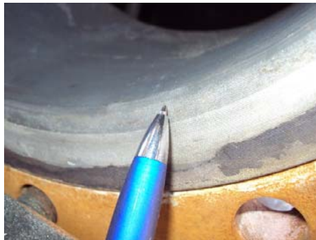
Prüfung der VP 10-500 Beschichtung nach 5 Jahren – intakt!
